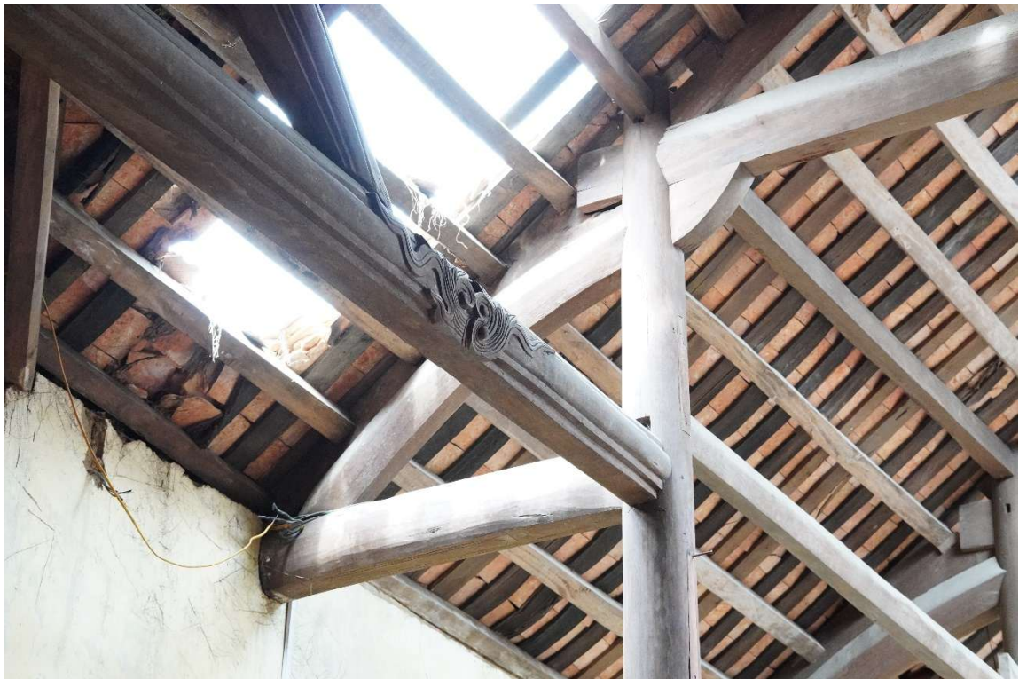
MÁI, NỀN THUỜNG ĐIỆN ĐÃ SẬP ĐỎ
